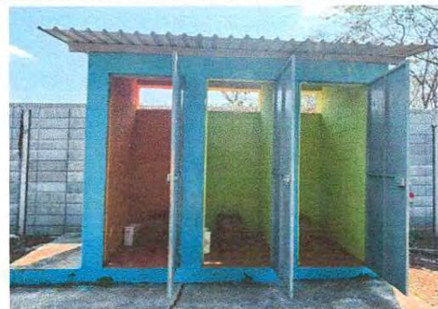
Foto 4: Se observa deterioro de lamina de los servicios Sanitario.
