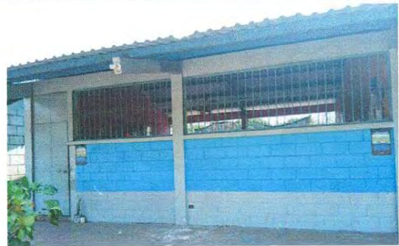
Foto 22: Se observa el deterioro de pintura del Modulo II
