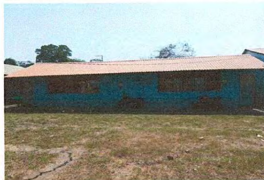
Foto 16: Se observa en mal estado los balcones del Modulo I
