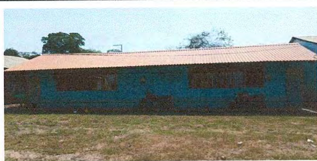
Foto 18: Se observa el deterioro de pintura del Modulo I
