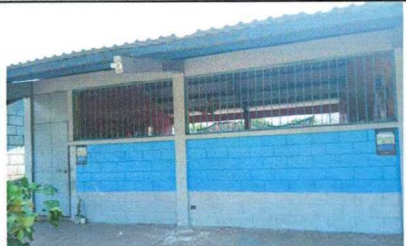
Foto 20: Se observa en mal estado los balcones del Modulo II
