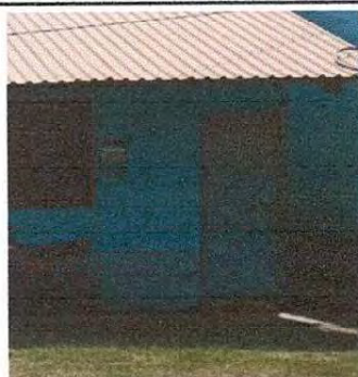
Foto 17: Se observa en mal estado la puerta del Modulo I
