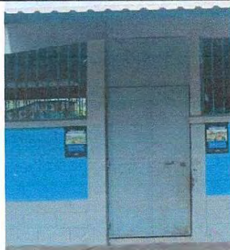
Foto 27: Se observa el deterioro de la chapa de la puerta Modulo III
