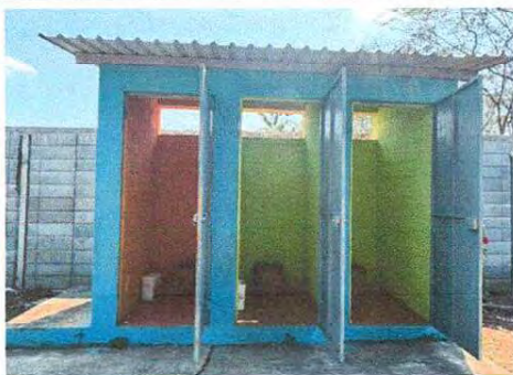
Foto 5: Se observa deterioro de puertas.
