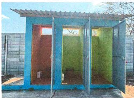
Foto 7: Se observa chapa en mal estado
