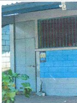
Foto 21: Se observa en mal estado la puerta del Modulo II
