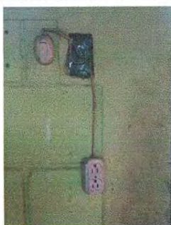
Foto 15: Se observa el mal estado de los accesorios electricos del Modulo I
