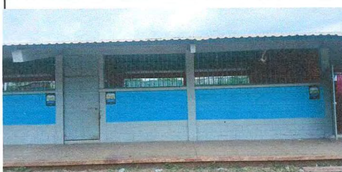
Foto 26: Se observa el deterioro de pintura del Modulo III
