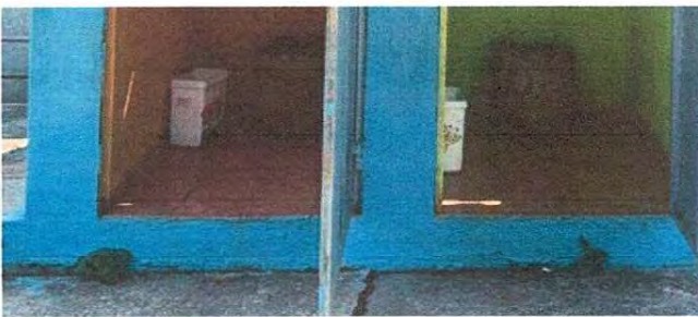
Foto 3: Se observa que en los baños el piso se encuentra con deterioro.
