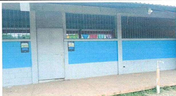
Foto 29: Se observa el deterioro de pintura en muro del Modulo VI
