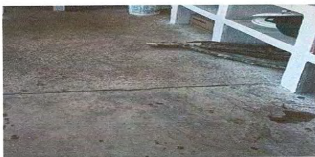
Foto 9: Se observa el mal estado del piso de la cocina.
