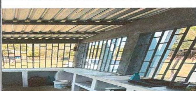
Foto 14: se observa que el interior de cocina no cuenta con pintura
