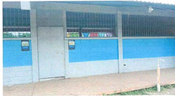
Foto 30: Se observa en mal estado los balcones del Modulo VI
