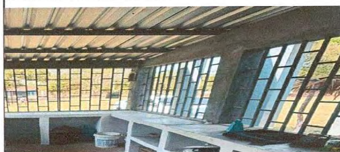
Foto 12: Se observa el deterioro fisico de los balcones de cocina
