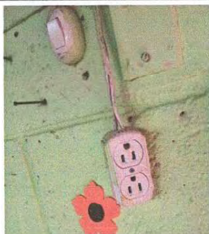
Foto 23: Se observa el mal estado de los accesorios electricos del Modulo III
