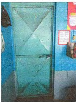
Foto 13: Se observa el deterioro de puerta de cocina
