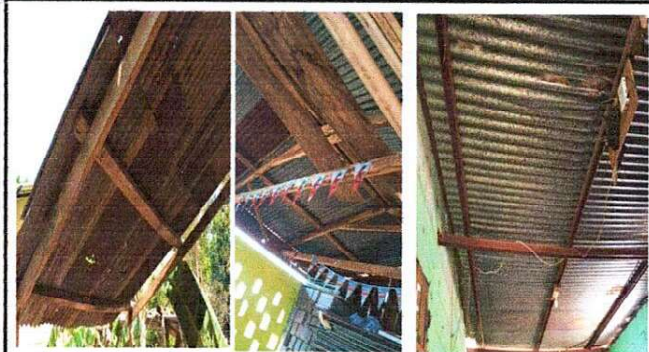
Foto 1: Se observa que la lámina galvanizada, se encuentra en mal estado. Por lo que se necesita cambio.
