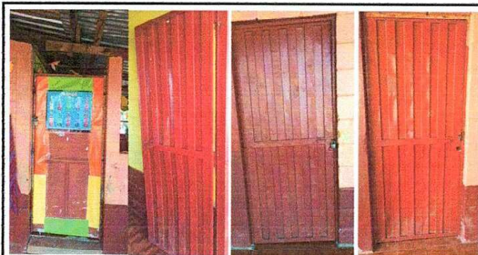
FOTO 3: Se observa que las puertas de metal se encuentran en mal estado por lo que se requiere de su sustitución.
