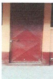
Foto 3: Se observa que las puertas actualmente en su mayoría poseen candado, el cual se va a sustituir por chapas yale de primera calidad.
