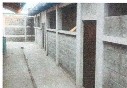
Foto 4: se observa que en las aulas actualmente no posee balcones y corren riesgo de personas que ingresen a robar.
