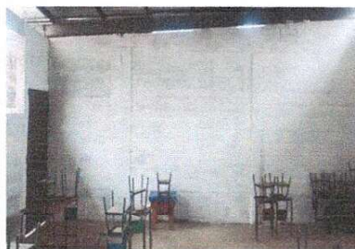
Foto 6: la pared de las aulas interior y exterior se necesita pintar para que se pueda mejorar el ambiente en las aulas de los niños y niñas de nivel inicial.
