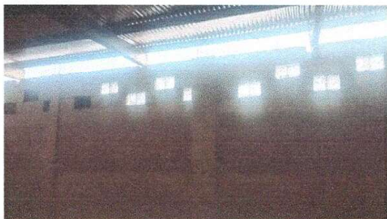
Foto 7: las aulas no tienen instalacion electrica lo cual lo hace oscuro y no permite actividades dinamicas donde se utilice material didactica con la electricidad.
