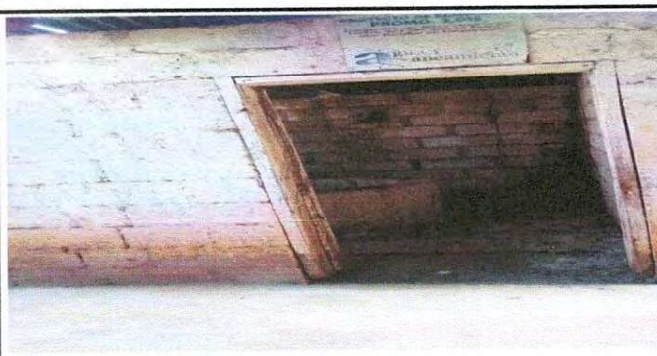
FOTO 18: Se observa el deterioro físico de las paredes del modulo de baños por lo que es necesario el suministro e instalación de azulejos.
