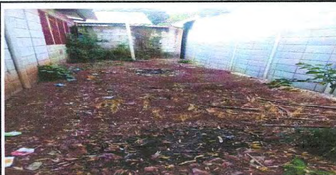
FOTO 20: Se observa que es necesario el suministro e instalación de tubería para drenaje .
