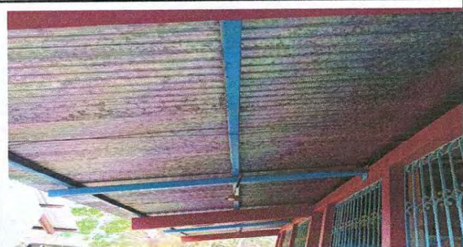
FOTO 9: Se observa el deterioro físico de la estructura por lo que es necesario su mantenimiento.
