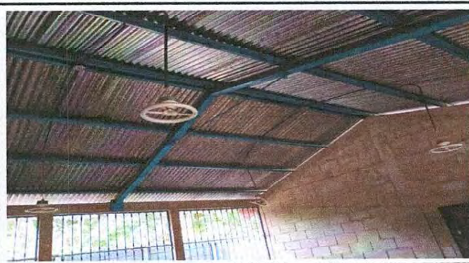
FOTO 2: Se observa el deterioro físico de la estructura por lo que es necesario el mantenimiento de la misma.
