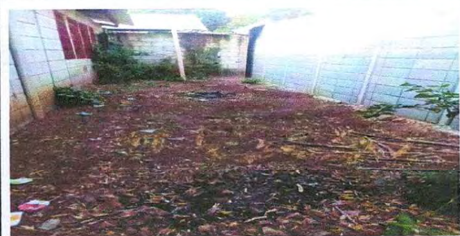
FOTO 21: Se observa que es necesario el suministro e instalación de Biogestos para inodoros lavables.
