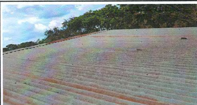
FOTO 8; Se Observa el deterioro Físico de la lámina por lo que es necesario el mantenimiento de la misma.
