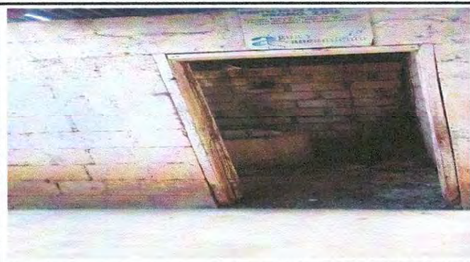
FOTO 19: Se observa que es necesario el suministro e instalación de piso cerámico. En modulo de sanitarios.
