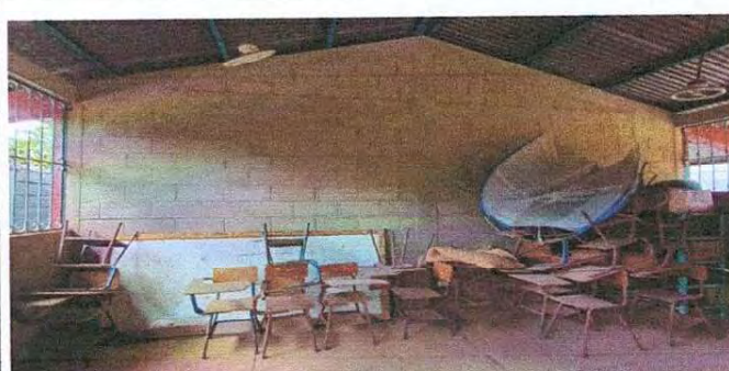
FOTO 4: Se observa que es necesaria la aplicación de pintura latex acrílica en paredes de módulos de aula 1.
