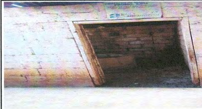
FOTO 26: Se observa el deterioro físico de la puerta de madera por lo que es necesaria la sustitución por puerta de metal.
