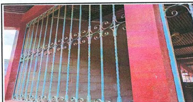
FOTO 5: Se observa el deterioro físico de los balcones por lo que es necesario el mantenimiento.
