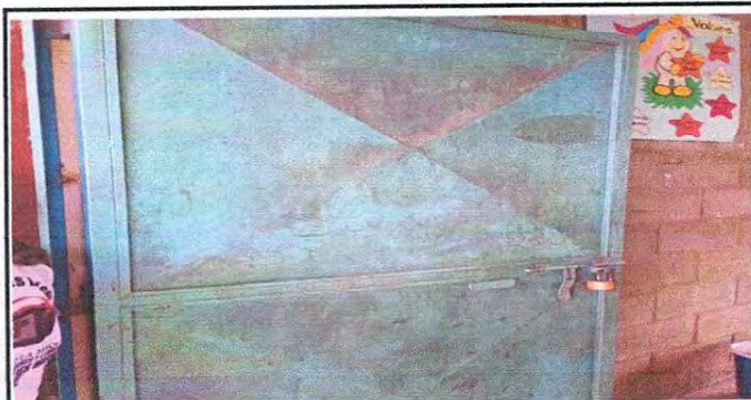
FOTO 10: Se observa el deterioro físico de la puerta de metal por lo que es necesario el mantenimiento,
