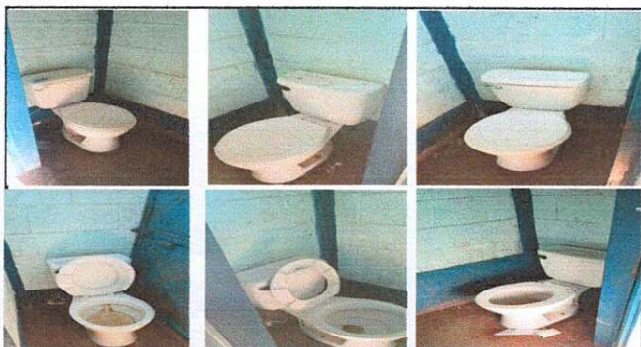
Foto 3: se observa que los inodoros se encuentran en mal estado. Por lo cual se necesita cambio.
