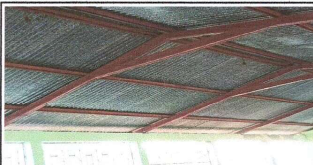
Foto 2: se observa que la estructura portante de metal necesita remosamiento.
