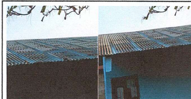
Foto 1: Se observa que la lámina galvanizada, se encuentra en mal estado. Por lo que se necesita cambio.
