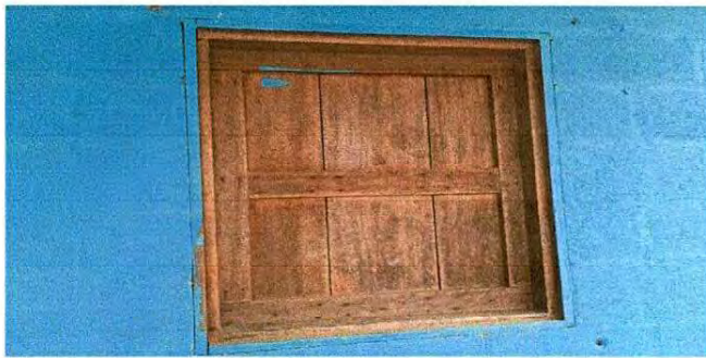
Foto 3: Se observa que la ventana de madera requiere sutitución por ventana de metal ya que se encuentra en mal estado.
