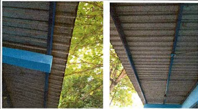
Foto 1: Se observa que la lamina de aluzinc se encuentra en mal estado por lo que es necesaria su susitución.
