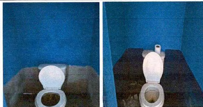
Foto 8: Se observa que es necesario el suministro y la instalación de azulejos en paredes del módulo de sanitarios.
