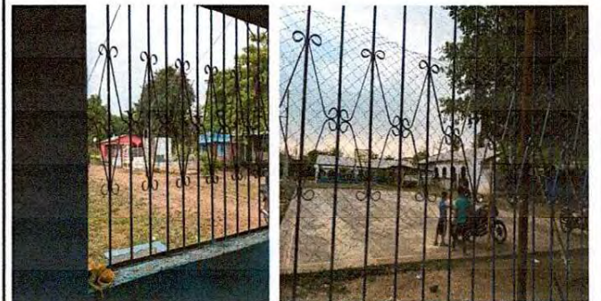
Foto 4: Se observa que los balcones de metal requieren mantenimieno con pintura anticorrosiva.
