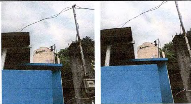
Foto 10: Se observa que el rotoplast se encuentra en mal estado por lo que es necesaria su sustitución.
