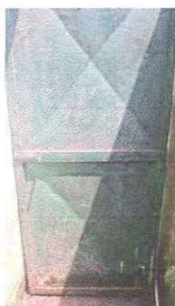
Foto 15: Se observa deterioro por oxido de puertas en el módulo de parvulos que requieren sustitución
