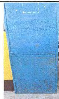
Foto 12: Se observa deterioro de puertas por oxido y desprendimiento de las puertas de los marcos. Se les debe dar mantenimiento.
