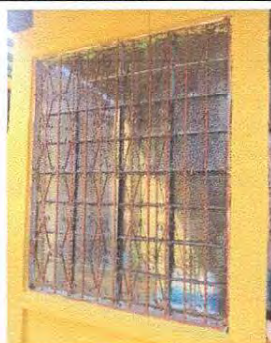
Foto 9: Se observa deterioro de ventanas de metal + vidrio al ingreso a cocina.
