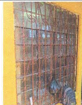
Foto 10: Se observa tambien el deterioro del balcon de la ventana de cocina
