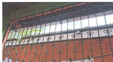
Foto 14: Se necesita colocar ventanas de pvc + vidrio
