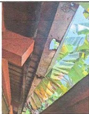
Foto 13: Se observa canales con agujeros por el deterioro provocado por el óxido, no cuentan con bajada de agua.
