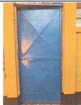
Foto 8: Se observa deterioro de puerta de la cocina por lo que necesita de mantenimiento ( lijado, cambio de tubo , cepillado, sujeciones, aplicación de pintura)
