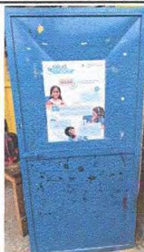
Foto 3: Se observa puertas en mal estado por lo que se requiere de sustitución.
