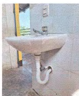
Foto 11: Se observa que el sifon esta roto, la llave esta quebrada y gotea, por lo que se necesitan reparar los lavamanos.
