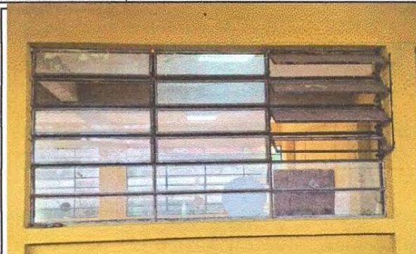
Foto 1: Se observa deterioro de ventanas del modulo uno, por lo que se debe retirar y en su lugar se suministrará e instalará balcones de metal.
