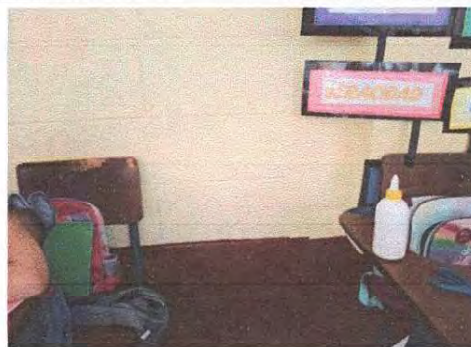
Foto 2: Se observa ausencia de tomacorrientes en las aulas
