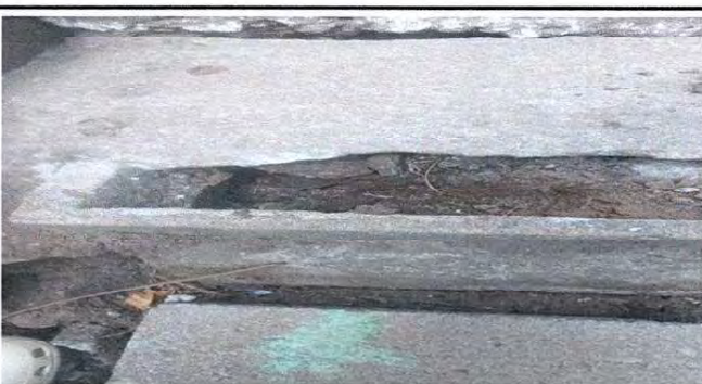
Foto 12: Se observa caja de registro en mal estado.
