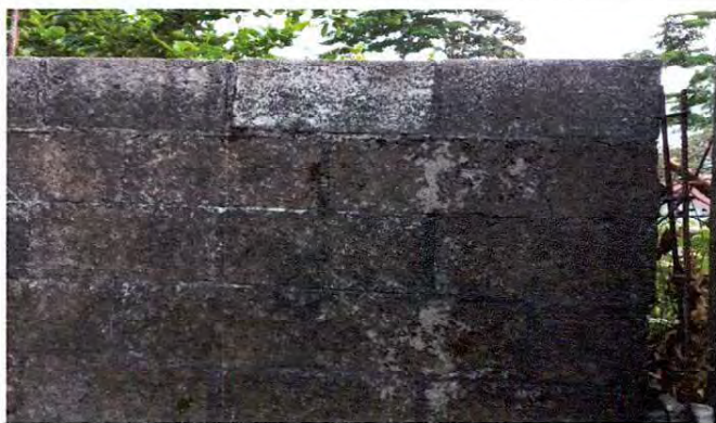
Foto 7: Se observa que el muro esta en malas condiciones.
