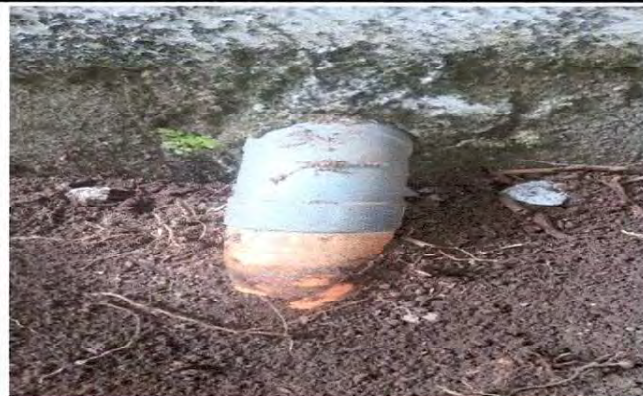
Foto 8: Se observa que la tubería de aguas negras estan mal estado.
