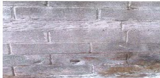
Foto 6: Se observa que no se cuenta con repello en los muros
