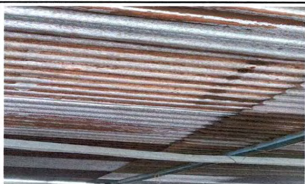
Foto1: Se observa que las laminas se encuentran en mal estado, se deben cambiar.
