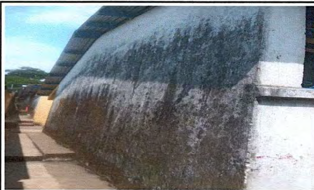
Foto 14: Se observa el deterioro de pintura en muros exteriores e interiores.
