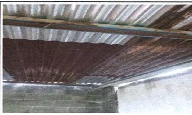
Foto 2: Se observa que las costaneras ya estan oxidadas y deterioradas.
