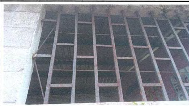
Foto 4. Se observa que es necesario sustituir los balcones, debido a su deterioro.
