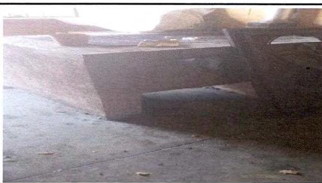
Foto 10: Se observa que la estufa no esta en optimas condiciones para su uso.
