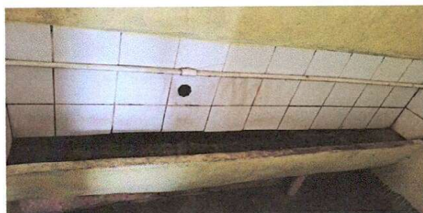
Foto 10: El mingitorio, está agrietado y tiene derrames de orina, que caen al suelo, se necesita demolerlo y sustituirlo
