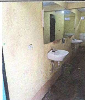
Foto 9: Los muros en los baños, se dañan y se estan descascarando, es necesario colocarles azulejo.
