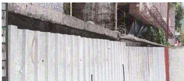
Foto 3: El canal de concreto que recibe el agua de lluvia del laboratorio de computación, está rajado y es insuficiente para la cantidad de agua que recibe, es necesario sustituirlo.
