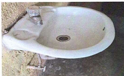
Foto 8: Los lavamanos, estan deteriorados y derraman el agua, es necesario reemplazarlos
