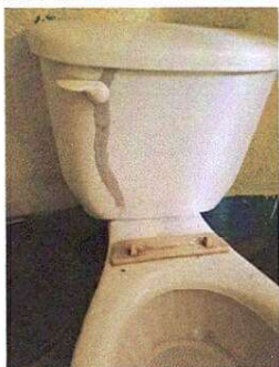
Foto 7: Se observa los inodoros en mal estado, urge sustituirlos
