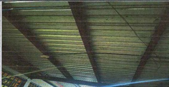
Foto 4: La estructura de soporte esta en mal estado representa peligro a los niños
