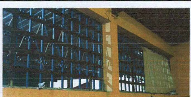
Foto 6: La pintura del balcon esta en malas condiciones
