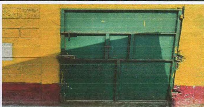
Foto 5: Las puerta de las aulas y entrada principal estan picadas y oxidadas
