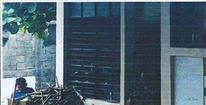
Foto 7: El balcon esta oxidado y en mal estado
