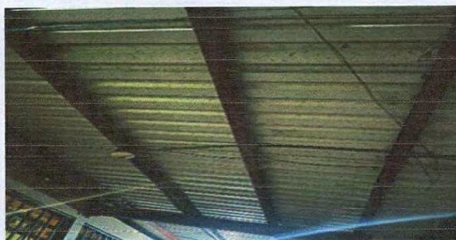
Foto 10: El sistema electrico esta en mal estado no cuenta con lamparas
