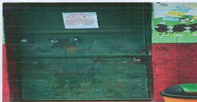
Foto 2: La pintura se esta levantando del metal
