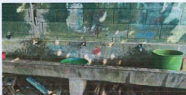
Foto 9: El lavamanos esta en malas condiciones y con agujeros
