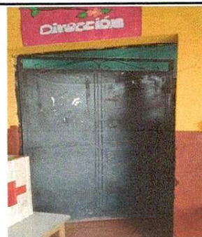
Foto 6: Se observa que las puertas de la Dirección se encuentran oxidadas y sin color.
