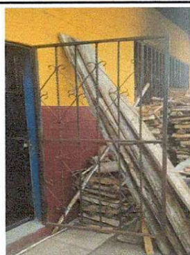
Foto 9: Se observa que el balcon se encuentra ya oxidado y en mal estado.
