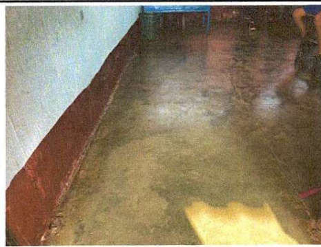
Foto 2: Se observa que el piso de las aulas se encuentra deteriorado, no apto al ambiente adecuado para los niños.
