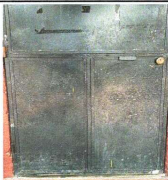
Foto 1: Se observan que las puertas están oxidadas.
