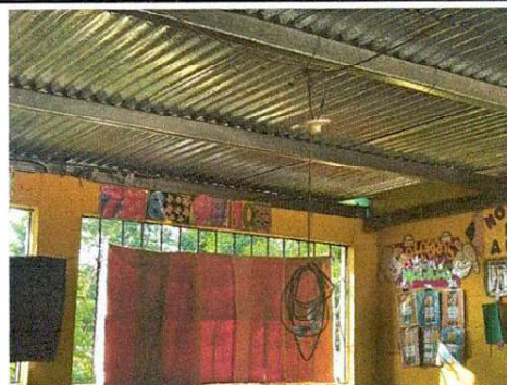
Foto 4: Se observa que los cables están en malas condiciones y reventados.
