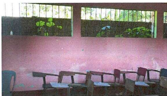
Foto 3: Se observa que la pintura se está levantando de la pared y tiene mohos.
