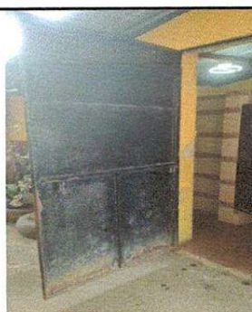
Foto 11: Se observa que las puertas exteriores estan ya oxidadas y podridas de la parte baja.
