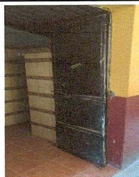
Foto 10: Se observa que las puertas no estan colocadas en los marcos de la pared y estan ya oxidadas.
