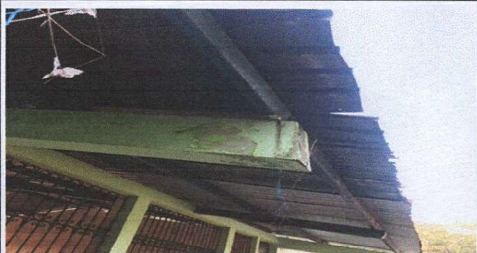
Foto 1: La lamina esta oxidada y en malas condiciones
