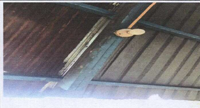
Foto 2: la estructura ya esta oxidada y dobla
