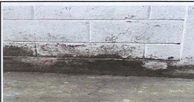
Foto 9: Se observa que la pintura se está levantando de la pared
