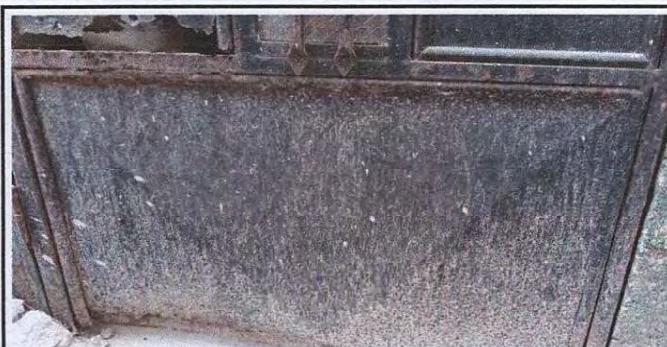
Foto 11: Se observa que las puertas están picadas por el óxido
