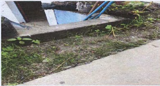
Foto 1: Se observa que el muro esta muy bajo
