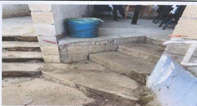
Foto 13: Se observa que el piso esta agrietado
