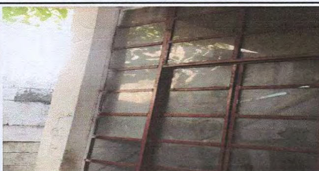
Foto 12: Se observa que las aulas están inseguras por no tener balcones
