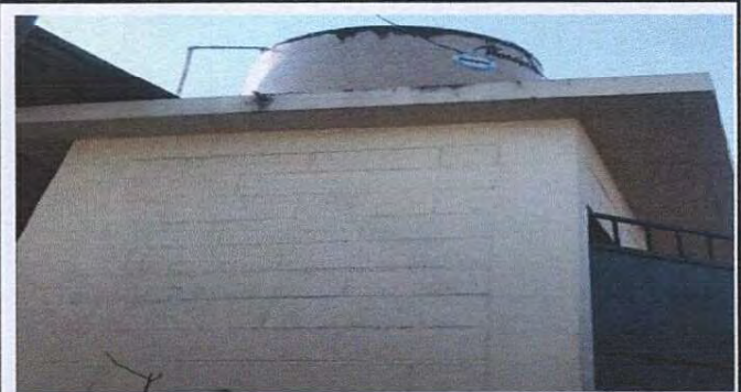
Foto 4: Se observa que El deposito por el tiempo en uso ya tiene fugas
