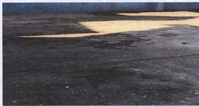
Foto 8: Se observa que el piso de cemento ya está agrietado y en malas condiciones
