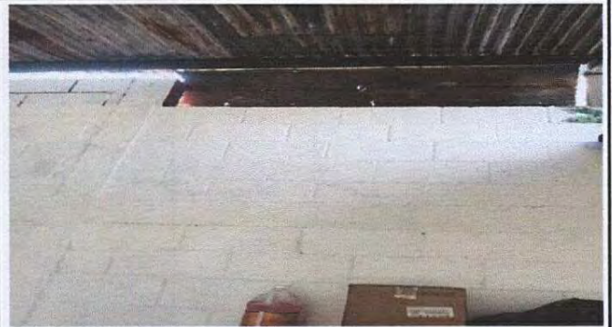
Foto 2: Se observa que La lamina esta muy oxidada y picada
