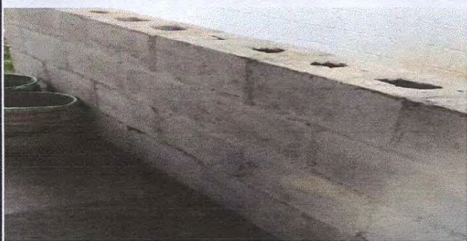
Foto 7: Se observa que el muro tiene filtración de humedad
