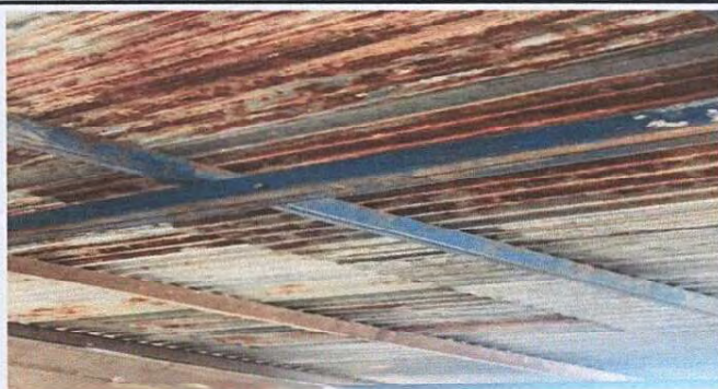
Foto 3: Se observa que El techo esta dañado y oxidado y es un riesgo para los niños
