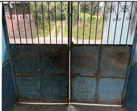
Foto 1: Se observa el mal estado del portón metálico
