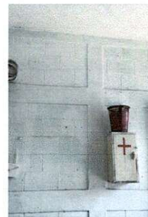
Foto 2: Se observa que la dirección no cuenta con pintura.
