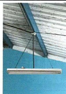
Foto 10: Se observa que las unidades eléctricas no se encuentran habilitadas.
