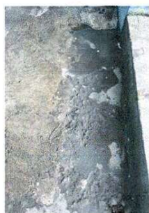
Foto 5: Se observa un mal estado en el piso de concreto.
