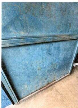
Foto 7: Se observa el mal estado de las puertas de aulas.
