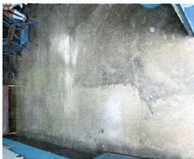
Foto 11: Se observa que las aulas no cuentan con piso cerámico.
