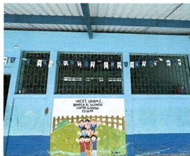
Foto 8: Se observa que las aulas no cuentan con ventanería.
