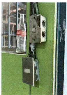
Foto 9: Se observa el mal estado del sistema eléctrico.
