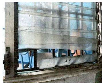
Foto 4: Se observa que no están en funcionamiento las ventanas en dirección.
