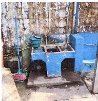
Foto 7: Se observa el uso de pila para el lavado de manos, la misma queda muy alta
