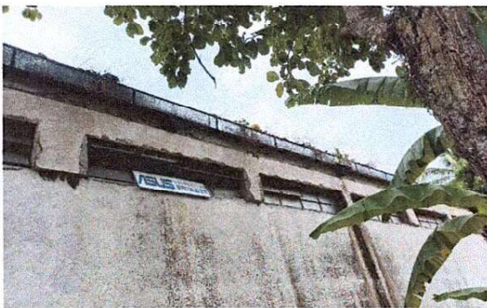
Foto 3: Se observa canal de agua pluvial en mal estado
