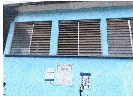
Foto 4: Se observa falta de balcones que dan al exterior
