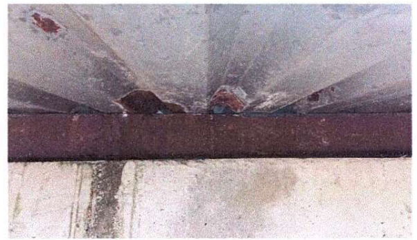
Foto 2: Se observan secciones de costaneras en mal estado
