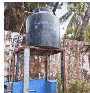
Foto 6: Se observa depósito de agua potable en mal estado
