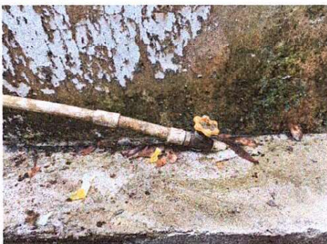
Foto 5: Se observa tubería principal muy pequeña y problemas de abasto
