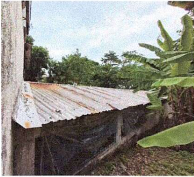
Foto 1: Se observa lámina en mal estado
