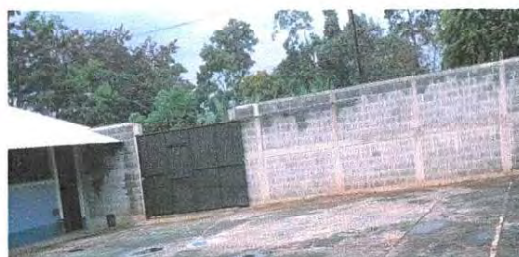
Foto 4: se observa el muro perimetral con ausencia de repello
