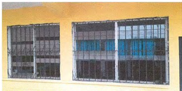
Foto 9: se observa el mal estado de las persianas.
