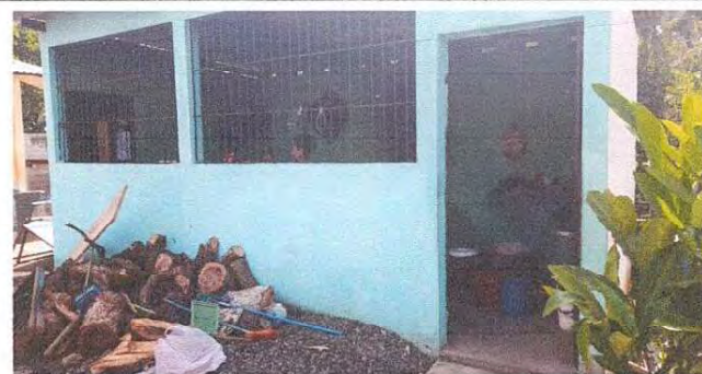
Foto 12: Se observa cocina sin puerta de ingreso.
