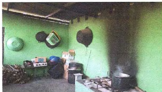
Foto 14: se observa en mal estado la pintura de muros de cocina.
