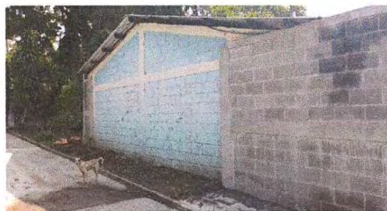
Foto 2: Se observa daño en pintura de muros.
