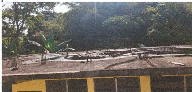
Foto 10: se observa filtración de agua en la losa
