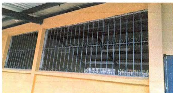
Foto 3: Se observa que la estructura esta en mal estado.
