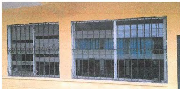
Foto 13: se observa deterioro físico en balcones de ventanas de cocina.
