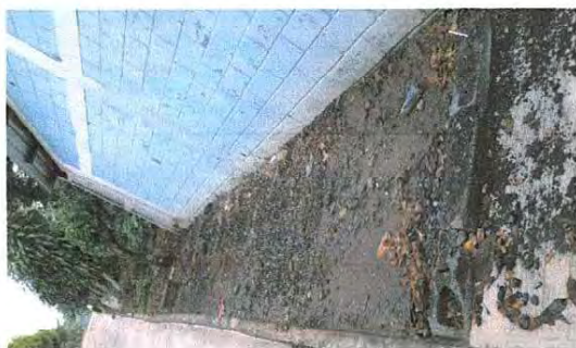
Foto 5: Se observa el mal estado de la banqueta.
