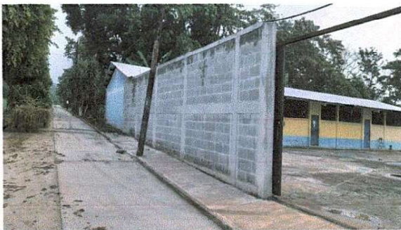
Foto 3: Se observa en falta de pintura en fachada.
