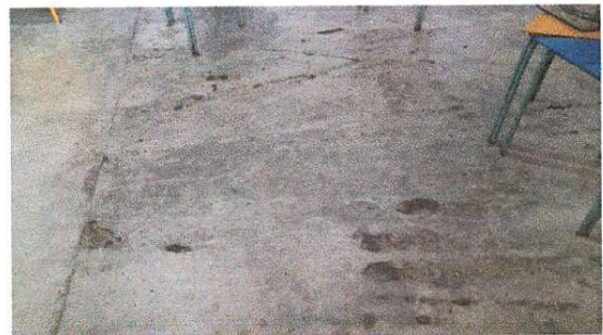
Foto 4: Se observa el piso en mal estado, grietas y fisuras
