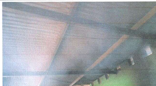
Foto 8: se observa deterioro de lamina de cocina.
