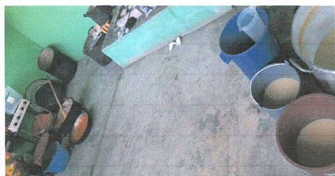
Foto 7: se observa deterioro de piso de cocina
