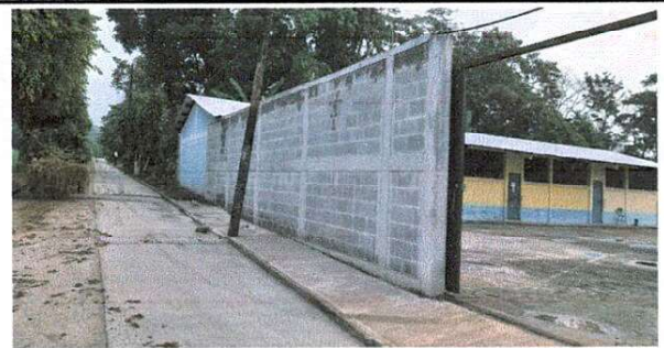
Foto 2: Se observa muro con ausencia de repello
