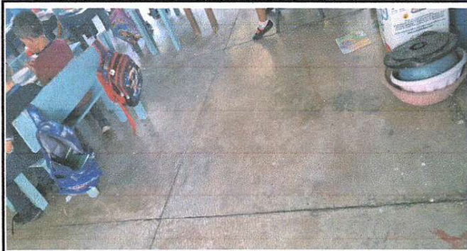
Foto 1: Se observa el piso en mal estado, grietas y fisuras
