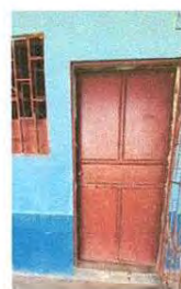
Foto 20: Se observa la puerta en mal estado.
