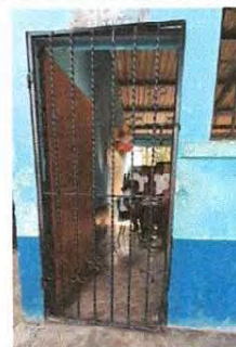
Foto 10: Se observa que las barandas de las aulas necesitan mantenimiento.
