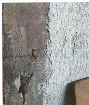
Foto 4: Se observa que las paredes necesitan cernido de muro en la cocina.
