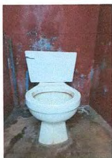
Foto 17: Se observa el inodoro en mal estado.
