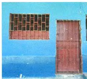
Foto 19: Se observa que en la biblioteca se necesita pintura.
