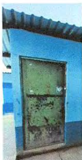
Foto 15: Se observa el mal estado de la puerta de la pila
