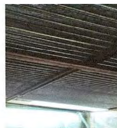
Foto 2: Se observa la Estructura de metal en mal estado en el área de cocina
