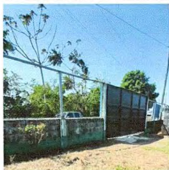
Foto 13: Se observa que el muro perimetral necesita pintura.
