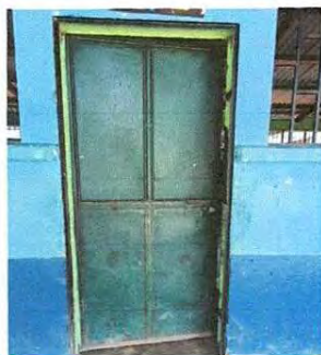
Foto 9: Se observa el mal estado de las puertas de las aulas.
