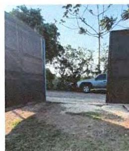
Foto 22: Se observa el mal estado de la Rampa de concreto en la entrada.
