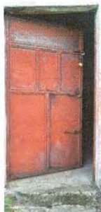
Foto 7: Se observa el mal estado de la puerta en la cocina.
