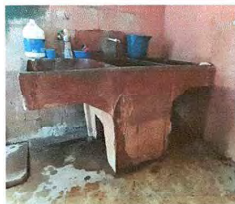
Foto 14: Se observa la pila con grietas y en mal estado.
