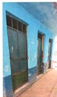
Foto 16: Se observa el mal estado de las puertas de los baños.
