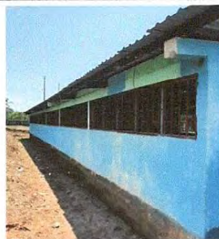
Foto 8: Se observa que los balcones necesitan mantenimiento.
