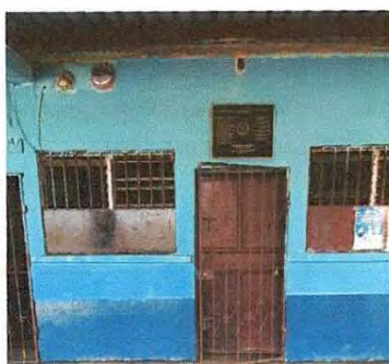
Foto 21: Se observa que en la dirección se necesita pintura.
