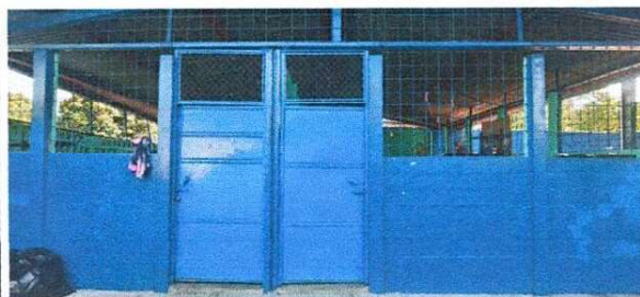
Foto 8: Se observa que se requieren barandas en las aulas para seguridad de los niños.
