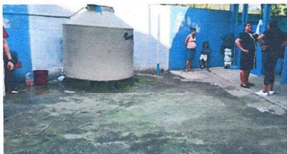
Foto 9: Se observa que las planchas de concreto se encuentran en mal estado.
