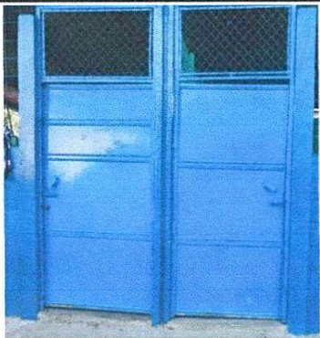
Foto 3: Se observa que las puertas requieren mantenimiento.
