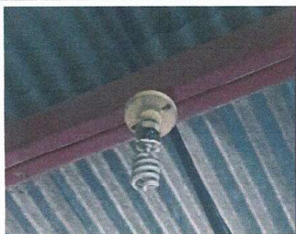
Foto 7: Se observa que los focos y la electricidad se encuentra en mal estado.
