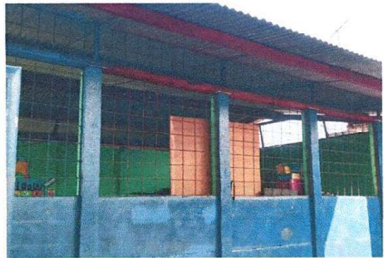
Foto 4: Se observa que los balcones necesitan sustitución.
