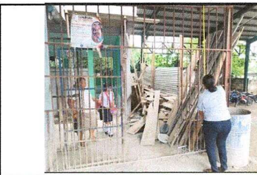
Foto 6: SE OBSERVA QUE EL PORTON DE INGRESO AL ESTABLECIMIENTO EDUCATIVO, ESTA EN MAL ESTADO, POR LO QUE ES URGENTE LA SUSTITUCION DEL MISMO.
