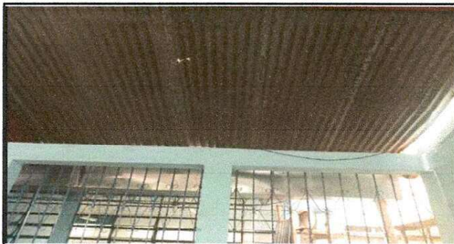
Foto 1: SE OBSERVA QUE EL TECHADO DE LAMINA ACANALADA, TIENE FILTRACION POR DETERIORO POR LO QUE ES NECESARIO LA SUSTITUCION DE CARÁCTER URGENTE.
