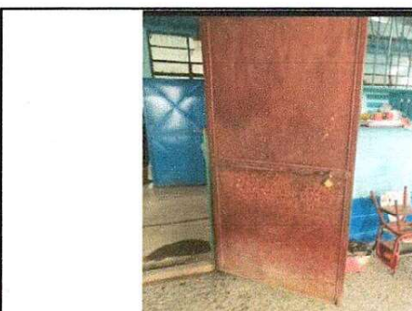
Foto 4: SE OBSERVA QUE LA PUERTA DE AULA SE ENCUENTRA EN MAL ESTADO REQUIERE DEL MANTENIMIENTO URGENTE.
