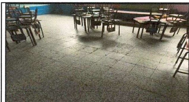
Foto 3: SE OBSERVA QUE EL PISO DE GRANTO ESTA EN MAL ESTADO , POR LO QUE SE NECESITA LA SUSTITUCION POR PISO CERAMICO URGENTE.
