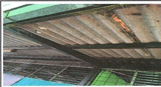
Foto 2. Se observa que la estructura portante requiere de mantenimiento preventivo.
