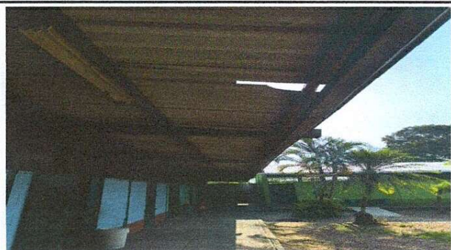
Foto 1. Se observa el mal estado de la lámina de asbesto cemento razón, por la cual se solicita la sustitución.
