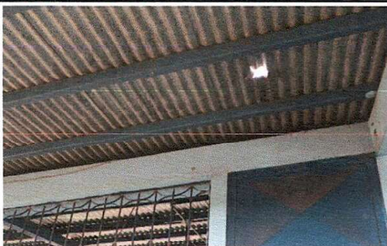
Foto 1: SE OBSERVA QUE LA LAMINA ACANALADA ESTA EN MAL ESTADO, LO ES IMPORTANTE EL CAMBIO DEL MISMO, POR LAMINA TROQUELADA
