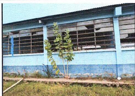
Foto 5: SE OBSERVA QUE LA PINTURA EN MURO SE ENCUENTRA DETERIORADA, POR LO QUE URGE LA APLICACIÓN DE PINTURA .
