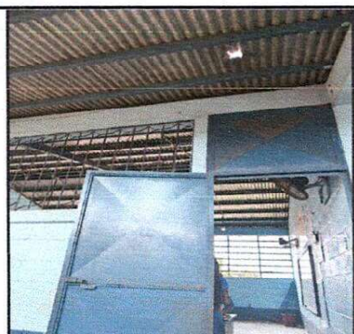
Foto 3: SE OBSERVA QUE LA PUERTA DE AULA ESTA EN MAL ESTADO POR LO QUE REQUIERE EL MANTENIMIENTO
