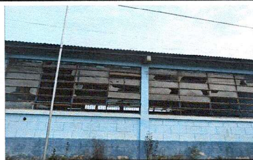
Foto 6: SE OBSERVA QUE LAS VENTANAS DE VIDRIO ESTAN EN MAL ESTADO, POR LO QUE URGE EL CAMBIO DE BALCONES .
