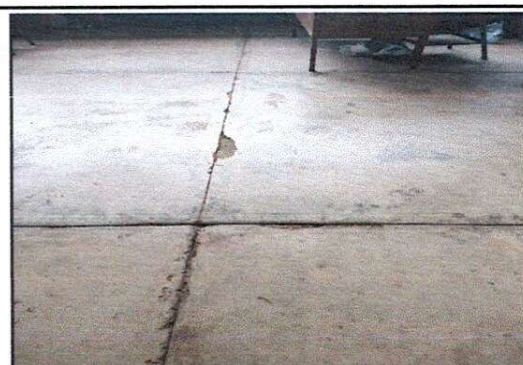
Foto 4: SE OBSORVA QUE EL PISO DE CONCRETO ESTA EN MAL ESTADO, POR LO QUE ES IMPORTANTE LA INSTALACION DE PISO CERAMICO URGENTE.
