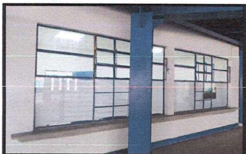
Foto 1: SE OBSERVA QUE LAS VENTANAS SON DE VIDRIO , POR LO QUE NO HAY SEGUIRDAAD EN EL MODULO QUE SE USA COMO DIRECCION, POR LO QUE URGE COLOCAR BALCONES DE METAL..
