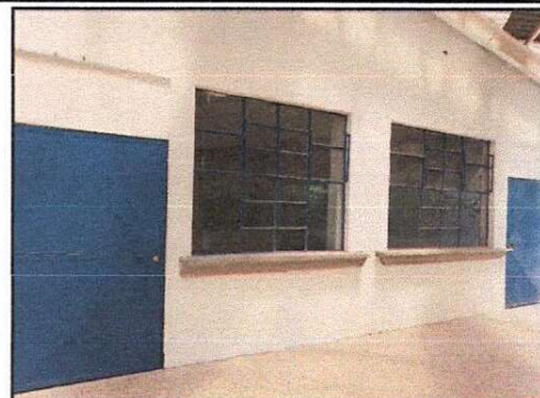
Foto 4: SE OBSERVA QUE LAS VENTANAS SON DE VIDRIO , POR LO QUE NO HAY SEGUIRDAAD EN AREA DE COCINA PARA RESGUARDAR LOS UTENCILIOS, ES IMPORTANTE BALCONES DE METAL, URGE COLOCAR.
