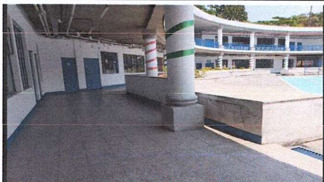
Foto 3: SE OBSERVA QUE LAS PAREDES NECESITAN QUE SE APLIQUE PINTURA, YA QUE SE ENCUENTRA DETERIORADA ES DE CARÁCTER URGENTE.
