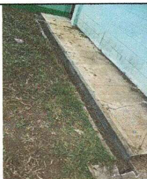
Foto 5: se necesita colocar rejillas adecuadas para que no ingrese basura y tape los tragantes de agua.
