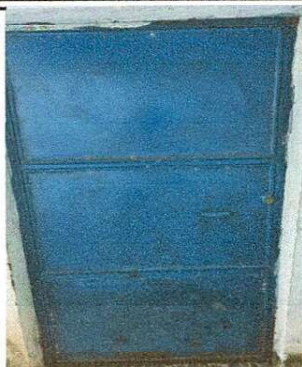
Foto 1: Se observa que las puertas necesitan mantenimiento
