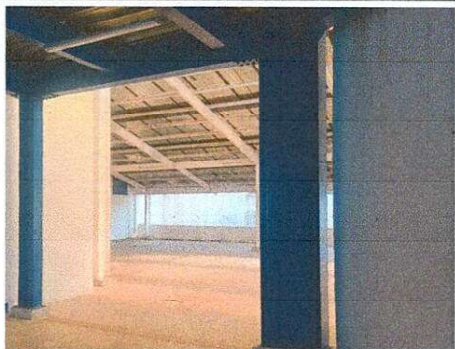
Foto 1: Se observa la necesidad de resguardar el área de gimnasio, es un espacio abierto, donde personas ajenas ingresan saltándose la pared, por lo que se requiere colocar un portón.
