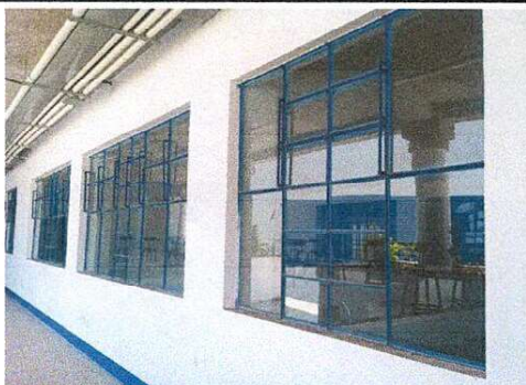
Foto 3: Se observa que las ventanas no son seguras para resguardar el equipo del laboratorio de ciencias, por lo que se requiere colocar balcones.
