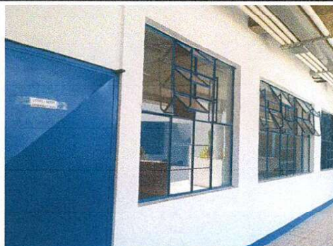
Foto 2: Se observa que las ventanas no son suficientes para resguardar el equipo de computación, por lo que se requiere la colocación de balcones.
