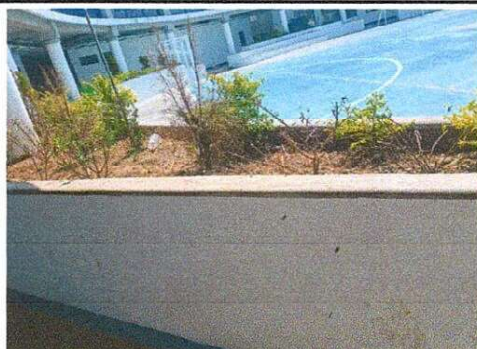
Foto 4: Se observa que las jardineras no tienen línea de agua, es necesario para el mantenimiento del jardín y evitar el polvo y las enfermedades respiratorias para los alumnos.
