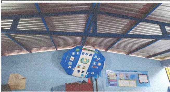
Foto #3. Se observa que en dos salones de clases hacen falta luminarias.
