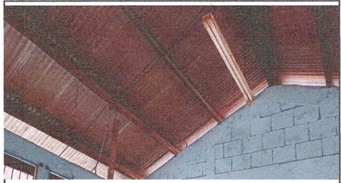
Foto #2. Se observa que las costaneras y toda la estructura necesitan pintura.
