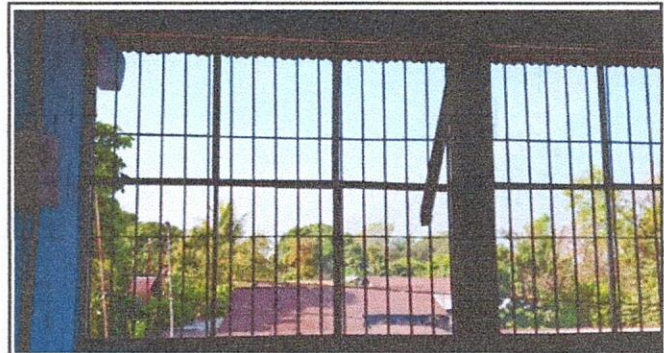
Foto #4. Se observa que en esos ventanales hacen falta las ventanas de paleta.
