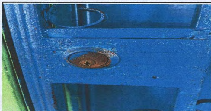
Foto 3: se observa que la chapa de de puerta necesita sustitción.
