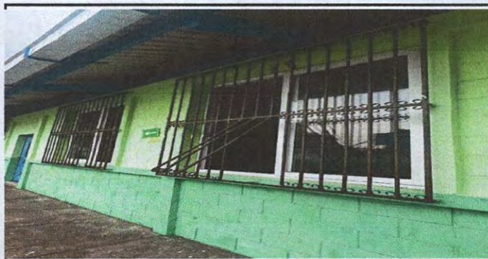
foto 6: Se observa el deterioro por completo de balcones de metal oxidadas y en mal estado lo pueden ser un peligro los hierros para los niños .
