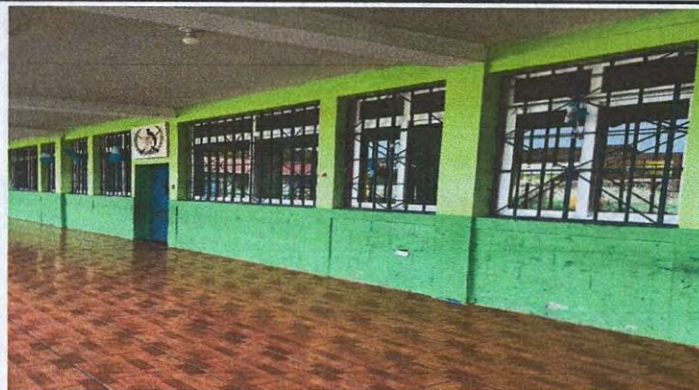
Foto 1: Se observa que los balcones no han tenido mantenimiento de lijado ni pintura módulo de aulas.
