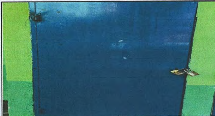
Foto 8: Se observa la puerta de baños han sido reparada en varias ocasiones siempre se cae por la mala calidad de material que fueran hechas lo cual provoca no poderle dar uso a los baños de preprimaria.
