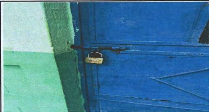
Foto 7: se observa la puerta de salón no cuenta con chapa no es segura solo con candado
