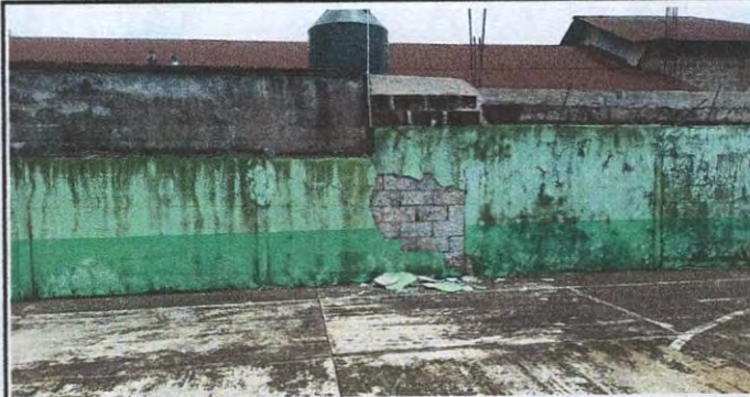
Foto 12: Se observa que las paredes del muro perimetral estan en malas condiciones, por las cuales necesita cernido.
