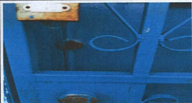
Foto 9: Se observa la chapa barrida de bodega sin poder colocarle llave lo cual se ha requerido colocar candados para su mayor seguridad.
