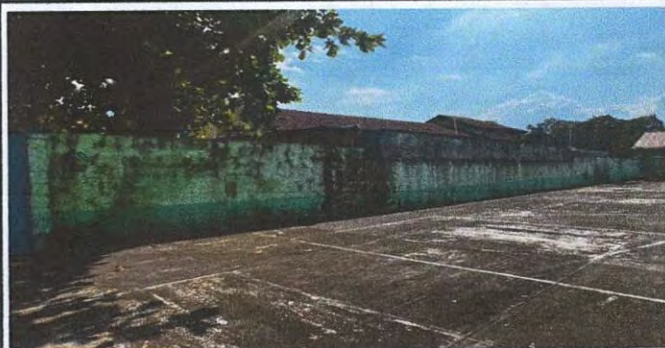
Foto 10: Se observa el muro perimetral en mal estado con moho sin mantenimiento necesita pintura
