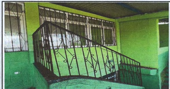
Foto 5: Se observa las barandas de las gradas están oxidadas, necesitan mantenimiento.
