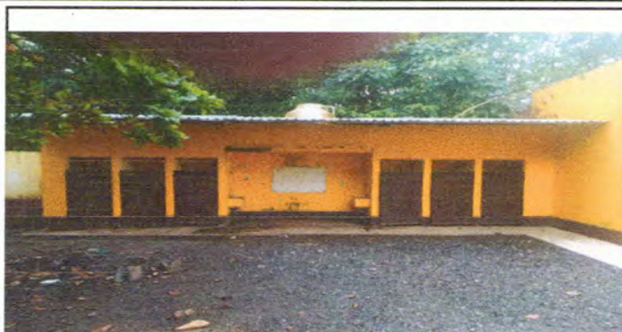
Foto 2: Se observa la falta de mantenimiento en los servicios sanitarios tanto paredes como lavamos.
