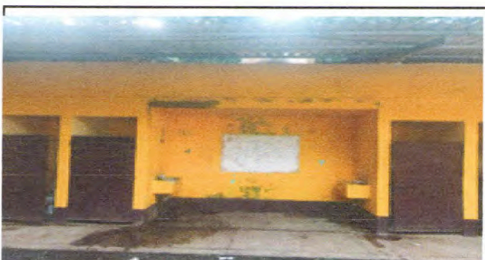
Foto 4: se ve la necesidad de darle mantenimiento a la pared de los lavamos, se colocara azulejo.
