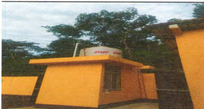
Foto 1: mejoramiento del sistema de agua, ya que el deposito le falta flote y a red de distrubucion tiene fuga.
