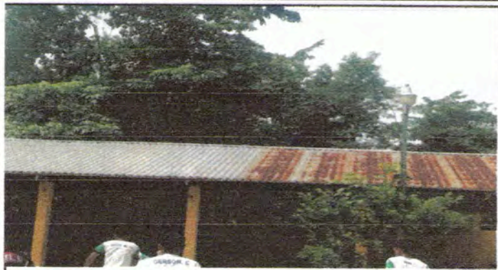
Foto 1: Se observa la necesidad de pintar la lamina ya que por el tiempo se ha ido oxidando esta es la parte que del salon que da a la cancha
