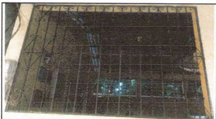
Foto 3: Se observa la necesidad de darle mantenimiento a las ventanas y la estructura metalica. Se nota la falta de mantenimiento de las ventanas
