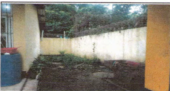
pared interior del establecimiento, se nota en la parte del muro la falta de mantenimiento ya que a perdido el color de la pintura
