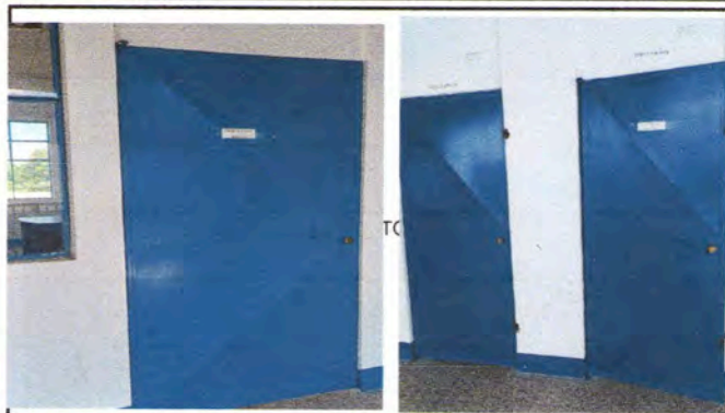
Foto 2: Se observa que falta suministro de puertas de rejías en Laboratorio de computación, dirección, bodega general y pasillo a gradas administrativas principal.
