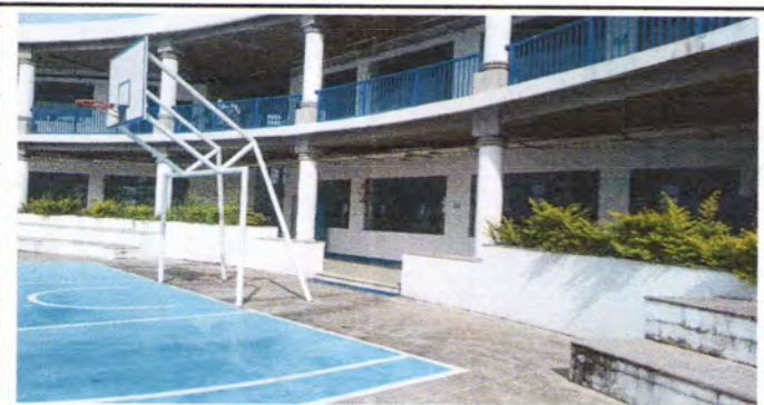
Foto 3: Se observa que faltan Sustitución de portones de tubo y malla bajo las porterillas de la cancha de basquetbol del módulo del nivel medio.
