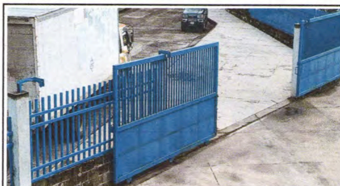
Foto 4: Se observa que falta Mantenimiento del portón principal de metal de 10 mts 2 de ancho cada ala (2) lijado, pintado.
