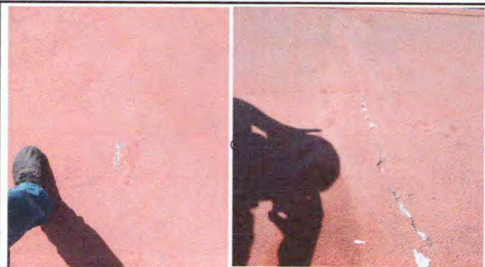
Foto 1: Se observa que el techo de loza esta agrietado necesita suministro de impermeabilizante
