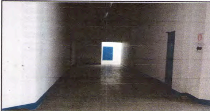
Foto 7: Se observa que se necesita Suministro de 1 puerta de metal principal de los baños femeninos del Gimnasio de la Escuela La Reforma.
