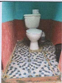
Foto 15: Se observa que los baños en las paredes juntan humedad, y se quiere azulejar tipo socalo para preveer el problema
