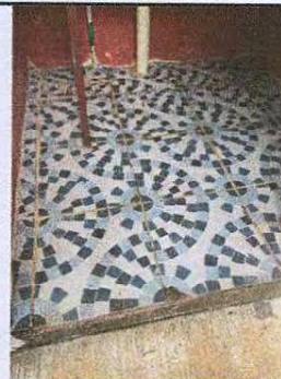
Foto 14: Se observa que los sanitarios cuenta con pisos antideslizantes en mal estado, y quebrados y mal colocados
