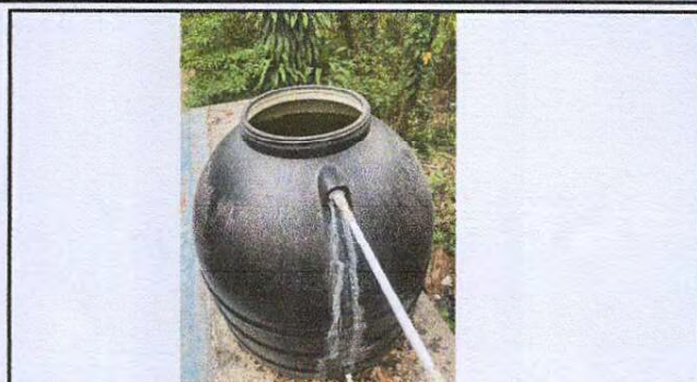
Foto 8: Se observa que el depósito de agua existente esta en mal estado y no cuenta con tapadera
