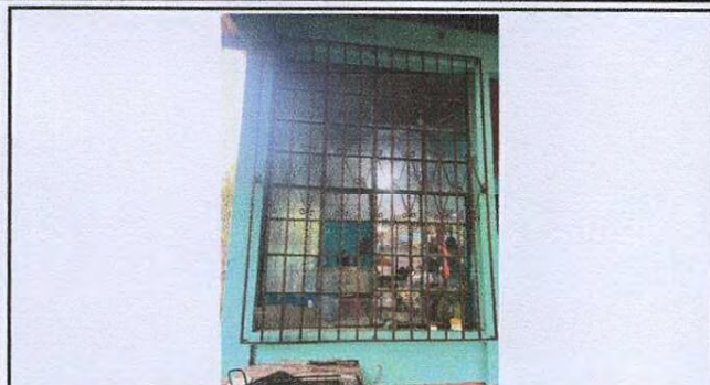
Foto 7: Se observa que en algunas ventanas se encuentran quebradas y en mal estado
