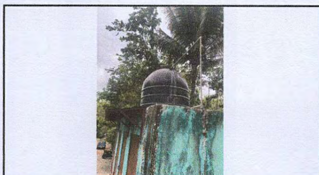
Foto 10: se observa que la linea principal de agua potable se encuentra en mal estado y el tubo cristalizado
