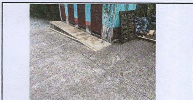
Foto 11: se observa que la escuela no cuenta con caja de registro
