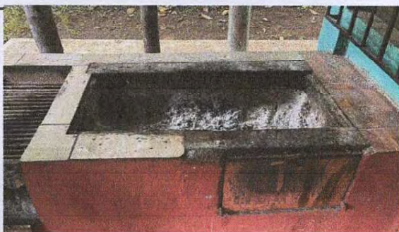
Foto 5: Se observa que el polleton artesanal no cuenta con plancha de metal para la colocacion de las ollas
