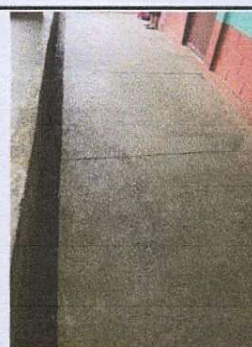
Foto 4: Se observa que el pasillo no cuenta con un piso adecuado
