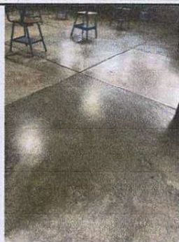
Foto 1: Se observa que el aula no cuenta con piso ceramico
