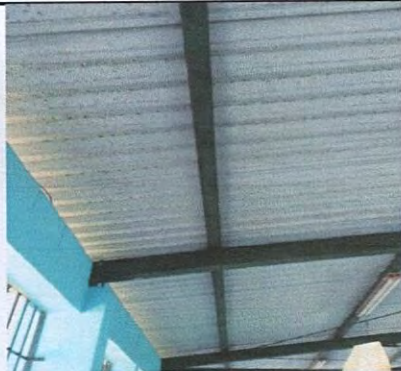
Foto 1: Se observa que la lamina acanalada existente esta en mal estado, por lo que necesita cambio urgente.
