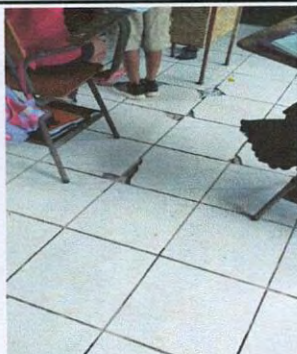
Foto 3: Se observa que el piso esta en mal estado, urge en mal estado.
