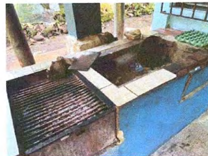
Foto 4: La cocina está dañada, es necesario repararla.
