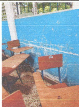
Foto 3: se necesita aplicar pintura en los muros
