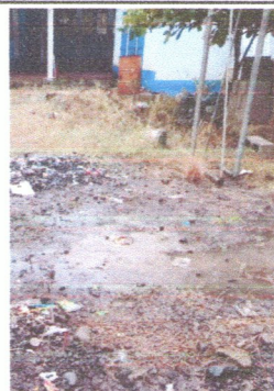
Foto 4: se necesita un encaminamiento de concreto en el patio, para comunicar los modulos con los baños, tenemos clases en la tarde y son unas correntadas de agua en el patio
