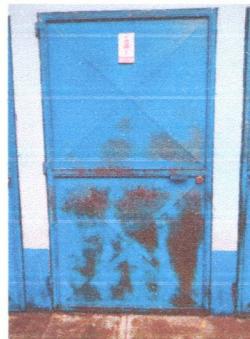
Foto 2: se necesita cambio de puerta
