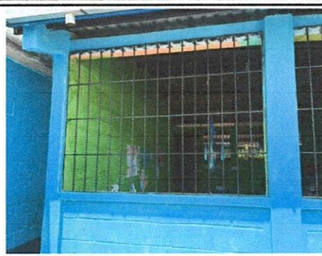
Foto 2: La lluvia ingresa al aula mojando todo alrededor, es necesario evitarlo.
