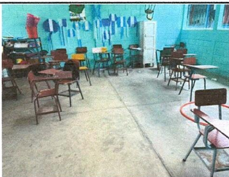
Foto 3: Es necesario mejorar las aulas con piso cerámico.
