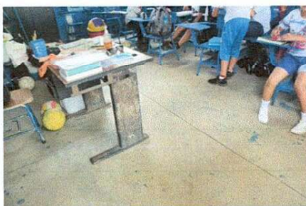
Foto 1: Se observa que el piso es de concreto, por lo que es necesario colocar piso cerámico.
