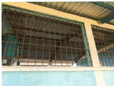
Foto 2: Se observan los balcones del modulo 1, los cuales están oxidándose y necesitan mantenimiento.
