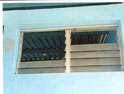
Foto 4: Se observa que las persianas se rompen y deterioran por no tener balcones que las protejan, es necesario colocar balcón de metal.
