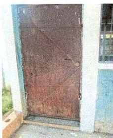
Foto 3: Se observa que la puerta necesita sustitución de chapa.
