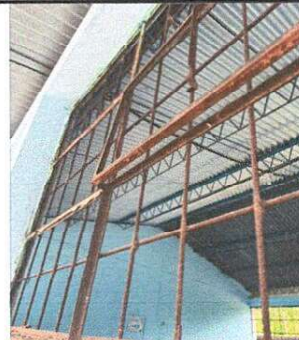
Foto 2: Podemos observar que los balcones del aula estan desgastados y deformados
