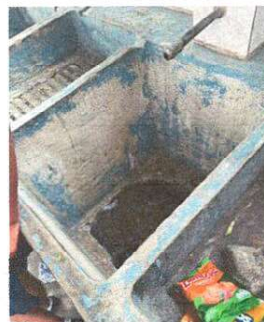
Foto 4: Podemos observar que las pilas estan complemente destruidas
