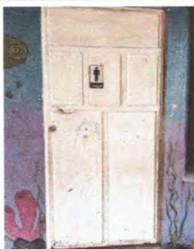
Foto 3: Se observan puertas con falta de mantenimiento
