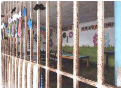
Foto 1: Se observan balcones con falta de mantenimiento
