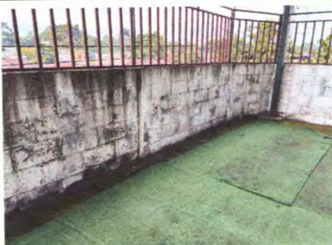
Foto 9: Se observa pared perimetral con moho y sin repello
