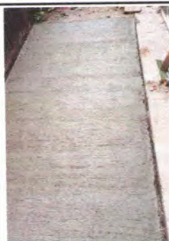
Foto 11: Se observa patio sin piso cerámico antideslizante
