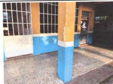
Foto 12: Se observan paredes sucias, ralladas y sin mantenimiento
