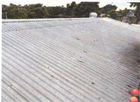
Foto 13: Se observa lámina troquelada con falta de mantenimiento
