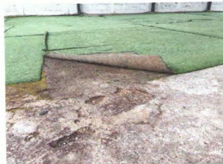
Foto 8: Se observa torta con pañuelos en mal estado
