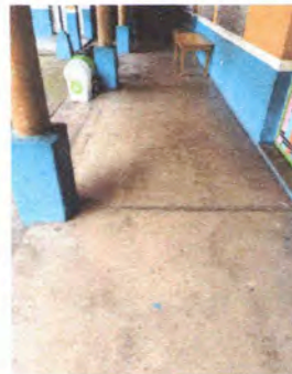
Foto 2: Se observa piso de concreto sin piso cerámico
