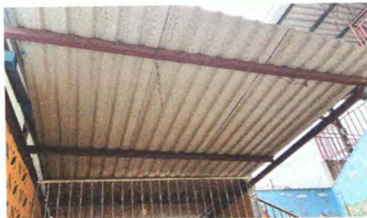
Foto 7: Se observa estructura de soporte con corrosión
