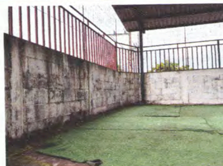
Foto 10: Se observa pared sin cernido
