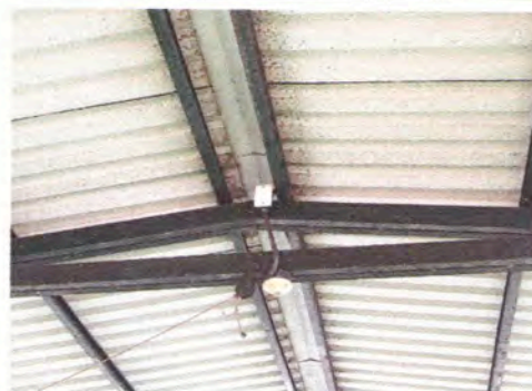
Foto 14: Se observa estructura de techo con falta de mantenimiento
