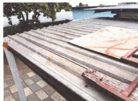
Foto 6: Se observa lámina de ingreso en mal estado
