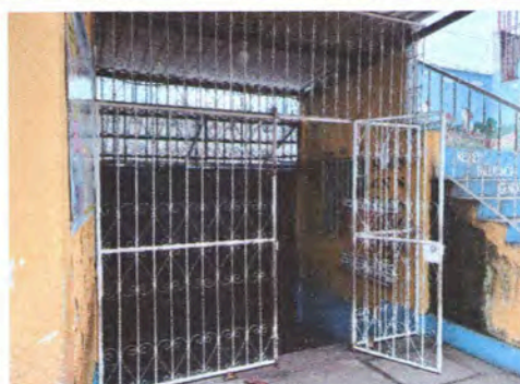
Foto 4: Se observa portón con falta de mantenimiento
