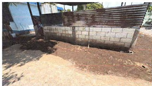
Foto 1: Se observa que no se cuenta con una base para colocar caminamiento.
