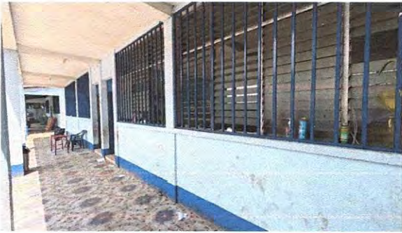
Foto 7: Se observa que la pintura está deteriorada.
