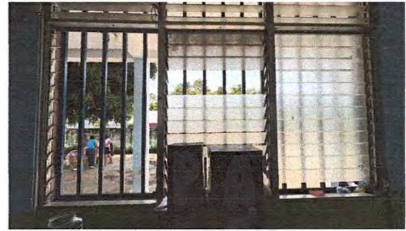
Foto 8: Se observa que faltan algunas piezas de vidrio en las ventanas.
