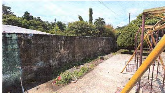
Foto 4: Se observa que el repello está deteriorado.
