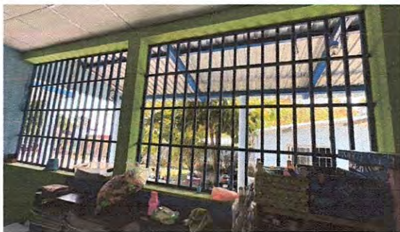
Foto 9: Se observa que no cuenta con ventanas en esta área.
