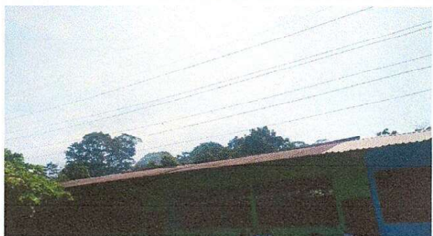
Foto 1: Se observa el techo del módulo que ya se encuentra deteriorado por la cual se requiere sustitución.
