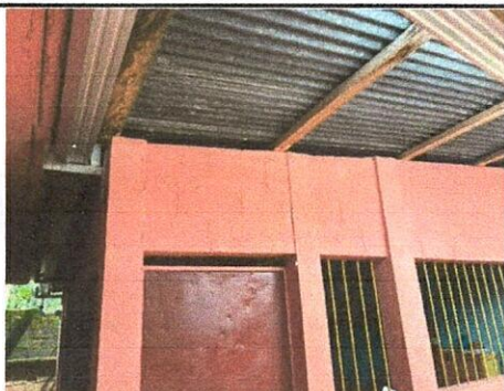
Foto 1: La cubierta del aula se encuentra en malas condiciones, es urgente mejorarla.
