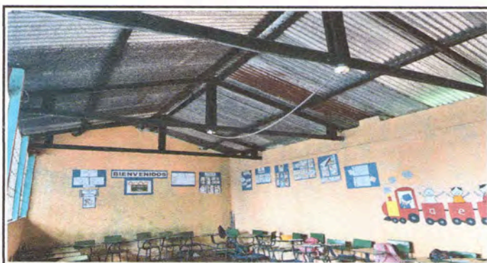
Foto 11: Se observa la necesidad de cambiar por completo lamina y estructura de madera por metal en salon del módulo tres.
