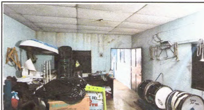
Foto 9: Se observa la necesidad de aplicar pintura en el interior del módulo 1.
