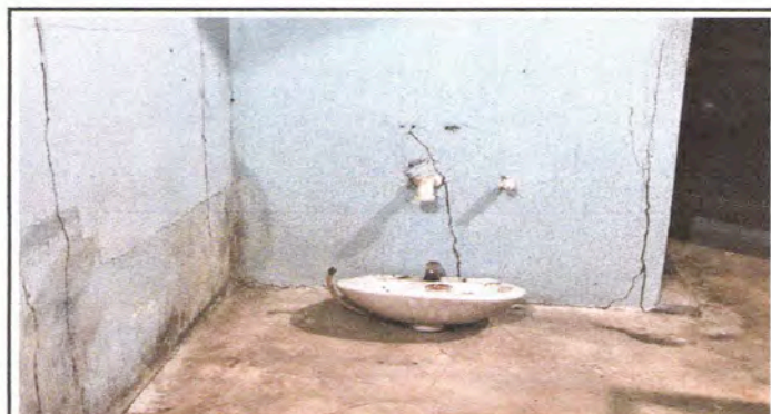
Foto 10: Se observa la necesidad de cambiar lavamanos.
