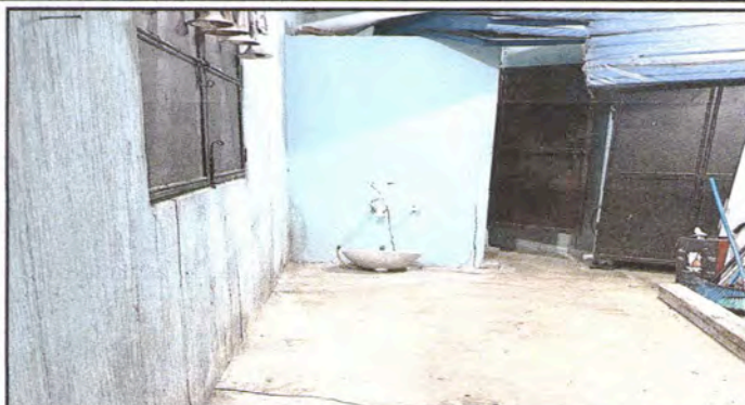
Foto 7: Se observa la necesidad de un suministro de drenaje para los baños y lavamanos.
