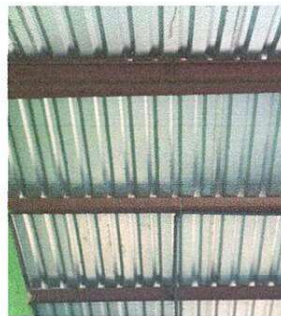
Foto 6: Se puede observar que las costaneras cuentan con oxido en los modulos de aulas.
