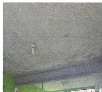
Foto 5: Observamos que la losa presenta filtraciones de agua.
