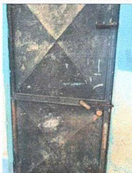
Foto 3: Observamos el mal estado de las puertas de la escuela, en la cual se aplicara el mantenimiento (lijado, pintado y cambio de tubo)
