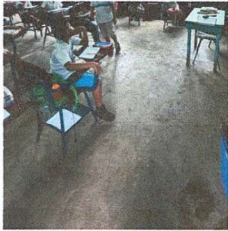
Foto 7: Se observa que el piso del aula es de concreto, se debera suministrar piso ceramico.
