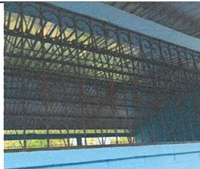
Foto 4: Podemos observar que los balcones se encuentran oxidados
