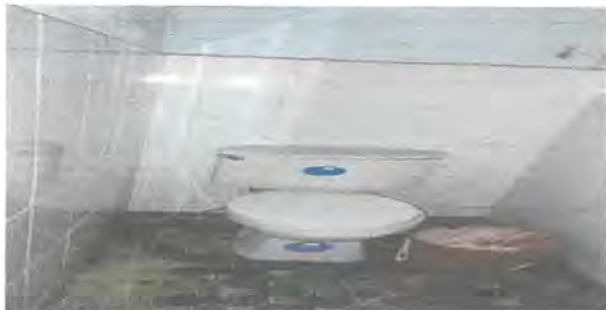
Foto 7: Se observa la necesidad de reparar los baños.
