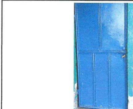
Foto 1: Se observa la puerta en el modulo de aulas 1, las bisagras están caídas y se encuentra picada, debe ser sustituida.
