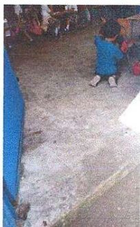
Foto 7: Se observa que el piso en las aulas del modulo 2 es de concreto rustico y los niños pueden raspase, debe instalarse piso cerámico.
