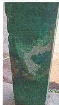
Foto 4: Se observa que en ciertas partes del modulo se esta cayendo el repello, como son las columnas y los marcos de las puertas, y deja al descubierto el concreto o block, es necesario aplicarlo nuevamente.
