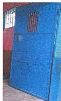
Foto 6: Se observa el mal estado de la puerta en el modulo de aulas 2.
