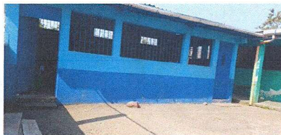
Foto 8: Se observa la pared del modulo 2, al cual se le aplicara pintura en muros pues esta se encuentra ya manchada.
