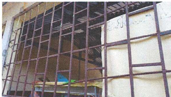
Foto 2: Se observa que los balcones se encuentran muy deteriorados y ya no cumplen su función de protección, por lo que hay que cambiarlos.
