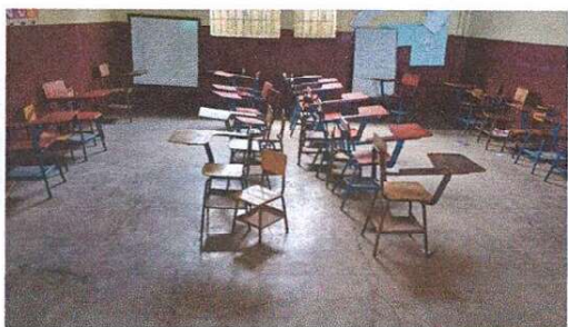
Foto 3: Se observa que el piso en las aulas del modulo 1 es de concreto, se debe instalar piso cerámico.
