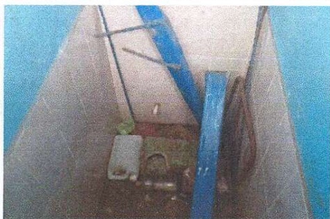
Foto 9: Se observa que no se cuenta con inodoros, se los robaron. Es necesario suministrar nuevamente para poder contar con el servicio.
