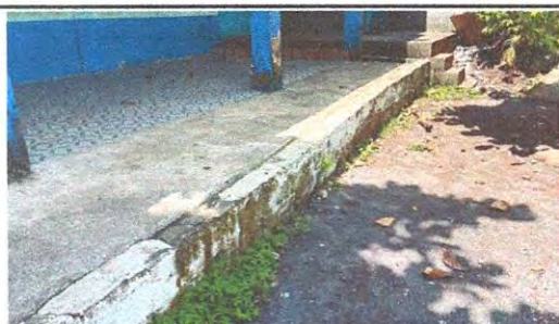
Foto 5: Se observa que se requiere de una rampa de concreto.
