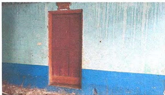
Foto 3: Se observa que la puerta no se encuentra en buen funcionamiento.
