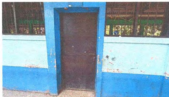
Foto 2: Se observa que las puertas requieren mantenimiento.
