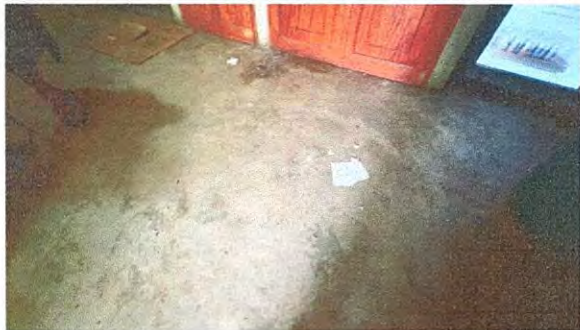
Foto 7: Se observa que no se cuenta con piso cerámico en la cocina.
