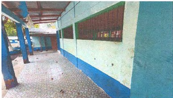
Foto 1: Se observa que la pintura de los muros se encuentra deteriorada.
