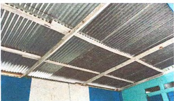
Foto 9: Se observa que la lámina del escenario se encuentra dañada.
