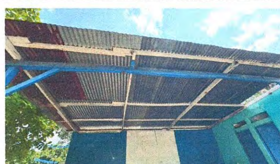
Foto 10: Se observa que la estructura ya se encuentra deteriorada.
