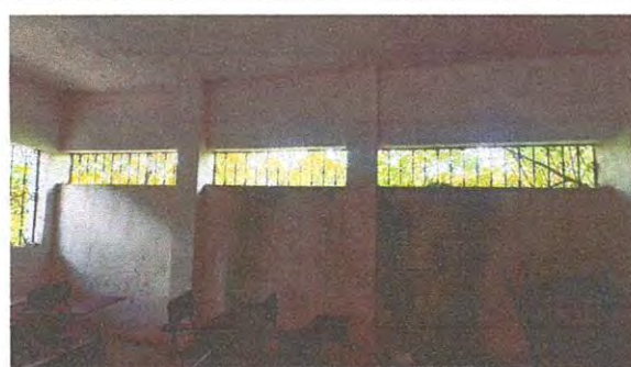
Foto 4: Se observa que se requieren ventanas ya que entra la lluvia.
