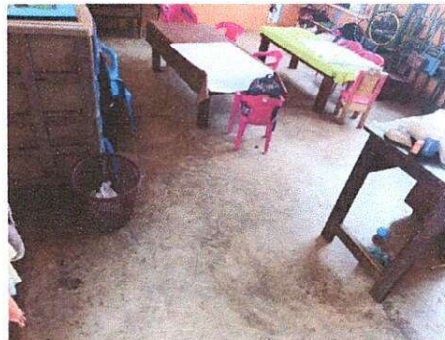
Foto 2: Se observa que el piso es de cemento, por lo que se necesita suministrar piso ceramico, tanto en aulas como en corredores.
