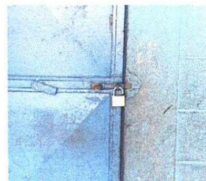
Foto 4: Se observa que las puertas del modulo 2 no cuentan con chapa, por lo que se debiera instalar una.
