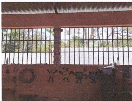
Foto 1: Se observa falta de ventanas, se necesita por el ingreso de agua cuando llueve
