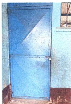
Foto 3: Se observa que las puertas del modulo 2 ya se iniciaron a picar, y necesitan mantenimiento.
