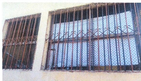
Foto 3: Se observa que los balcones de metal ya cuentan con oxido y necesitan mantenimiento.
