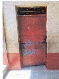
Foto 8: Se observa que las puertas del modulo 4 se encuentran muy dañadas y deben ser sustituidas.
