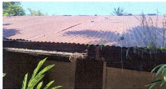
Foto 6: Se observa que las laminas del modulo 3 se encuentran dañadas y necesitan ser cambiadas.
