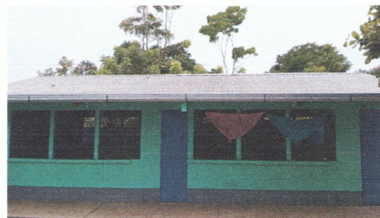
Foto 4: Se observa que las láminas encuentran en mal estado por lo tanto requiere mantenimiento.
