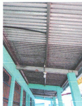
Foto 2: Se observa que las láminas de los salones se encuentran deterioradas por lo que es necesario sustituirlas.
