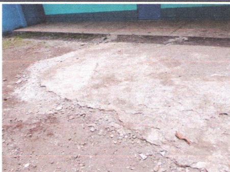
Foto 3: Se observa el área del patio se está deteriorando por lo cual es necesario sustituirla.
