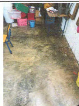
Foto 2: Se observa la necesidad instalar piso ceramico
