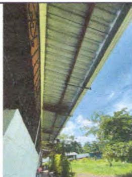
Foto 3: se observa la necesidad de instalar una estructura de soporte metalico
