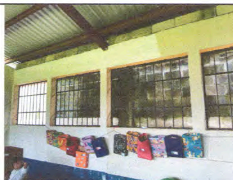
Foto 10: se observa la necesidad de instalar ventanas de pvc y vidrio
