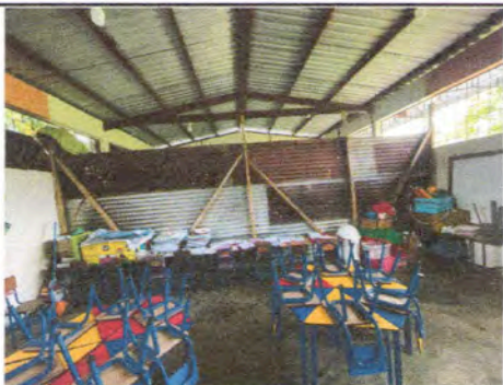
Foto 1: se observa la necesidad de sustitucion del paño de lamina y madera por un entrepaño de plywood
