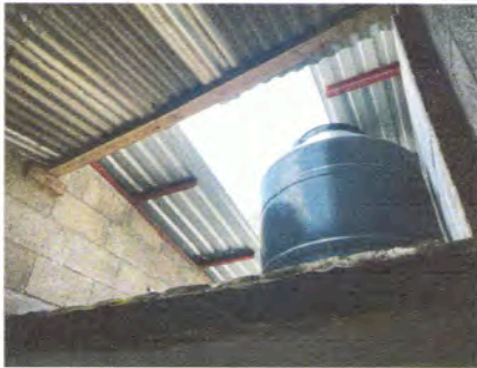
Foto 15: Se observa que no cuenta con proteccion y se necesita colocar balcon de metal
