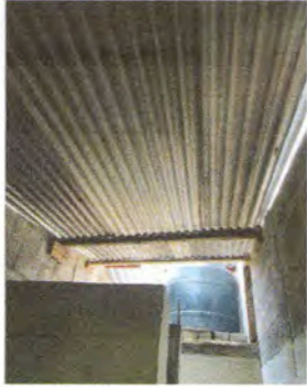
Foto 13: se observa la necesidad de sustituir la lamina existente por lamina troquelada
