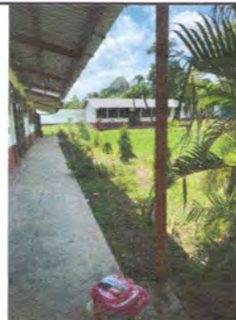
Foto 8: se observa la necesidad de instalar tubería de pvc en linea principal de aguas negras
