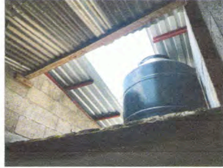
Foto 14: Se observa la necesidad de sustituir la estructura del soporte metalico
