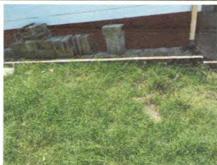
Foto 11: se observa la necesidad de colocar la plancha de concreto
