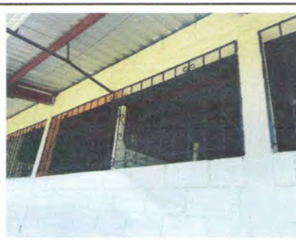
Foto 4: se observa la necesidad de instalar ventanas de pvc y vidrio
