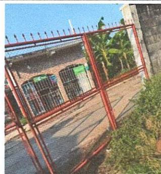
Foto 4: Se observa el area donde podemos observar que el portón cuenta con dificultades para abrirlo por adentro, se le dará manteamiento y corrección en el mecanismo de abertura
