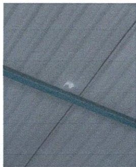
Foto 5: Se puede observar que en área de aulas, se presentan filtración, por las fisuras que tiene las láminas, por ende se cambiara el techado de lamina.
