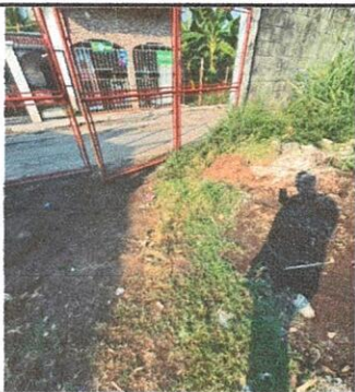
Foto 1: Se observa que el piso no cuenta con torta de concreto, se deberá suministrar un caminamiento.
